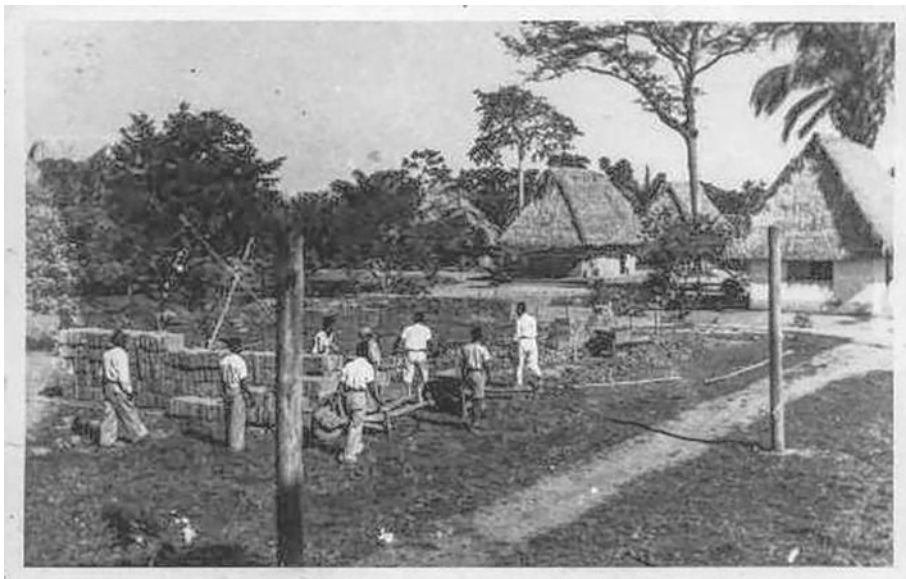
3. Trabajando en los cimientos de la capilla de Moré. Fuente: ALLC, Álbum de fotografías, lámina 7 rev.
