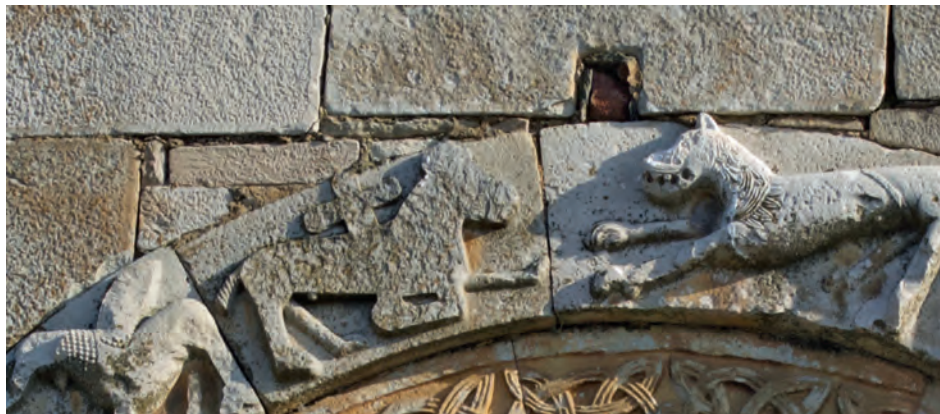
Fig. 20 – Détail du portail occidental. Les espaces importants entre les blocs de parement et l'extrados de l'arc surmontant le portail ont été comblés ici par des fragments de pierre, parfois non taillés, et un abondant mortier de chaux. On remarquera le claveau décoré de l'Agneau christique dont l'extrémité gauche semble avoir été redécoupée (P. Neri/CTC).
