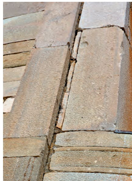
Fig. 23 – Détail du jambage sud de la fenêtre absidale. On notera la présence de trois éclats de pierre placés entre la lésène et le jambage afin de combler l'espace entre ces deux éléments. Dans la partie basse, ce rattrapage a été réalisé à l'aide de mortier de chaux (D. Istria/CNRS).
