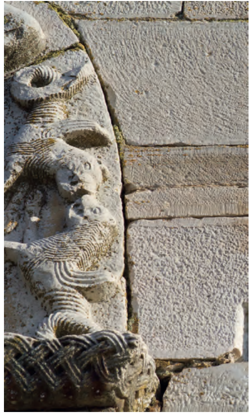
Fig. 21 – Détail du portail occidental. Les blocs, soigneusement taillés, ont été grossièrement redécoupés afin de s'adapter à l'extrados de l'arc surmontant le portail. Outre les épaufrures, on notera que les blocs n'épousent pas l'arrondi de l'arc et que des espaces importants et irréguliers ont été laissés entre les éléments (P. Neri/CTC).
