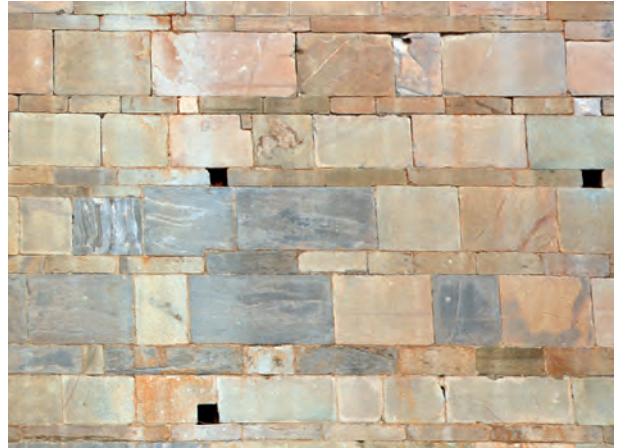
Fig. 17 – Portion du mur sud de l'édifice montrant l'alternance d'assises basses et d'assises hautes. On notera également les trous de boulins soit aménagés entre deux blocs d'une assise basse, soit façonnés dans un bloc d'une assise haute. Le rythme ABAB... est ici parfaitement respecté même si les variations de hauteur des blocs imposent quelques ajustements (D. Istria/CNRS).
