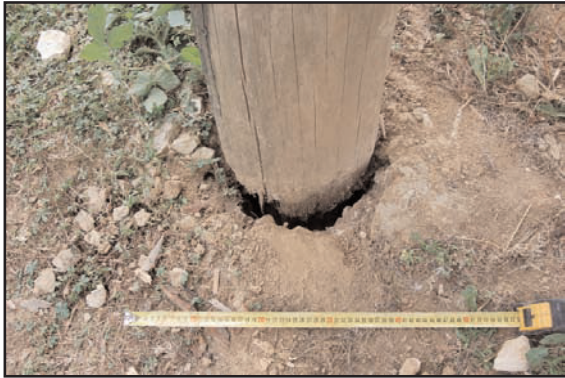
Fig. 18 : pied de poteau avec son aubier dégradé au contact du sol
