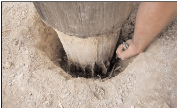
Fig. 22 : vue en profondeur du poteau avec le coeur du bois bien conservé
