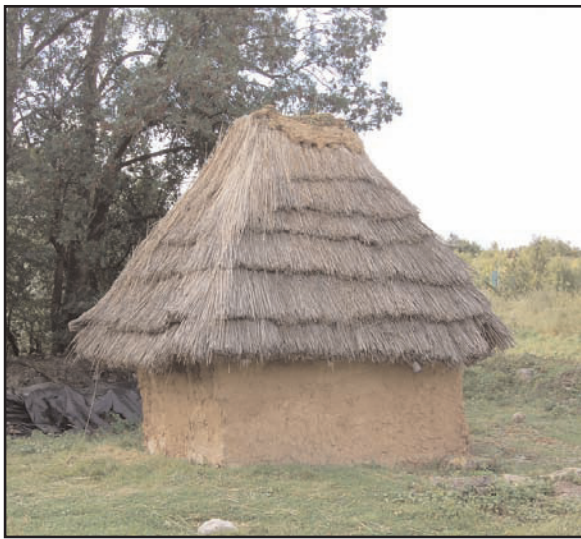
Fig. 24 : toiture dégradée de la cabane
