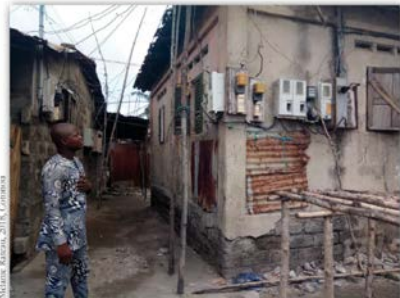
PHOTO 39 : MUR AUX COMPTEURS, DÉPART DES TOILES D'ARAGNÉE
