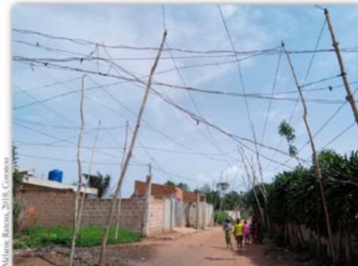
PHOTO 23 : EXTENSION DU RÉSEAU PAR TOILES D'ARAGNÉE DANS LE PÉJOURAÏN
