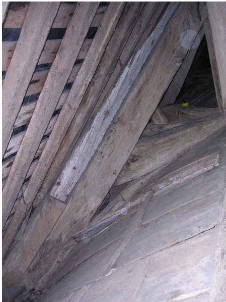
Cales placées entre l'arbalétrier et le chevronnage actuel pour combler le fléchissement du bois
