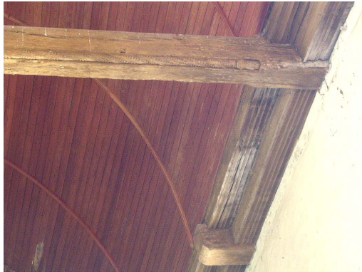
Entrait sculpté de la nef, avec en arrière plan les sablières moulurées.
