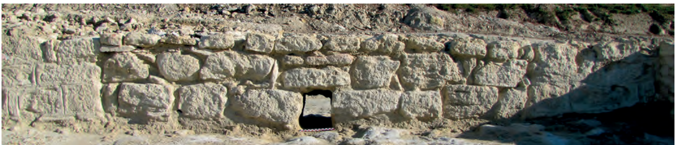
Fig. 142. Bâtiment 1, pièce 2. Parement ouest du mur 2002 avec ouverture murée et chantepleure (cliché Fr. Marty).
