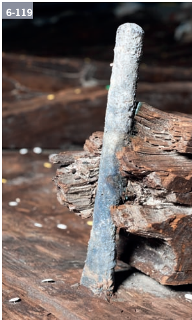
Fig. 6-119 La broche au niveau de la varangue M104 vue du sud-est. Compte tenu de la taille de cette broche qui dépasse la varangue, elle devait assembler aussi un élément axial interne (massif d'emplature du mât ou carlingue) (Cl. Ph. Groscaux).
