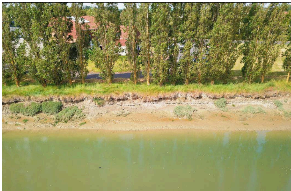
Photo 9 - Des digues vulnérables exposées aux risques côtiers. [cliché : auteurs, 2020]
