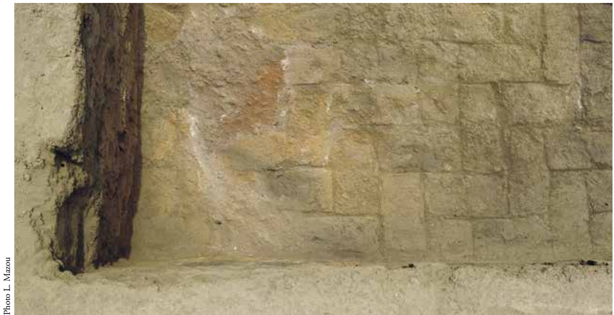
FIG. 9. P18, 2017. Phase 2, bâtiment 5, pièce 8. Traces d'incendie.
