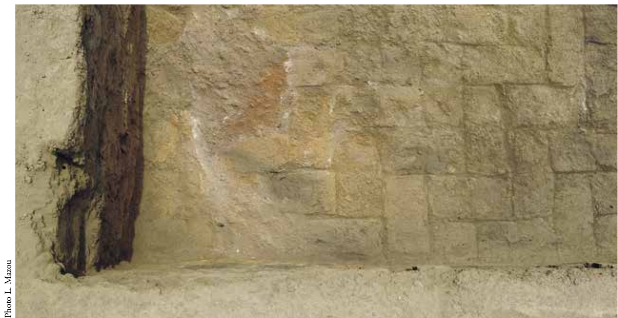
FIG. 9. P18, 2017. Phase 2, bâtiment 5, pièce 8. Traces d'incendie.
