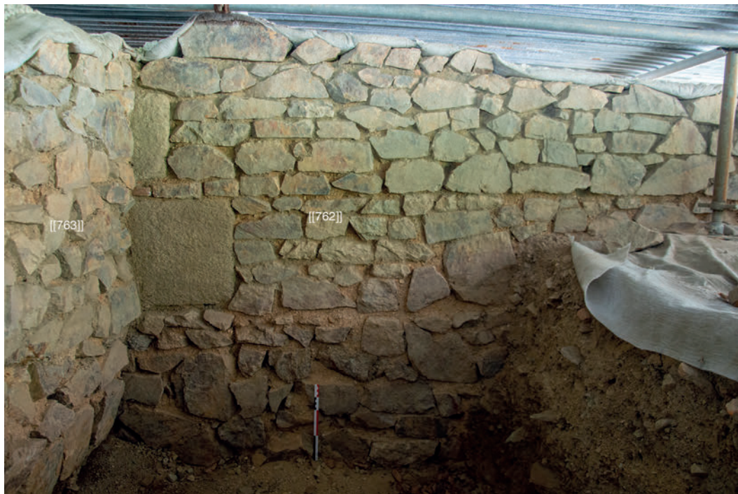
30. BibRACTE, Mont Beuvray. La domus PC2. Vue vers l'ouest des blocs de granit de grand appareil visibles dans le mur [[762]]. Le mur [[763]] n'est pas chaîné avec le reste des maçonneries, (cliché N. Scavone).
