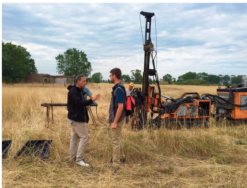
Photo des opérations de carottage en cours / Foto delle operazioni di carotaggio in corso (Photo L. Guinebault).
