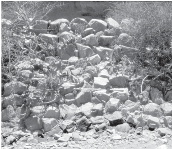
Figure 23. Détail de la mise en œuvre côté wādī du tronçon amont du mur déflecteur d'Hajar al-Dhaybiyya : six assises antiques surmontées par trois assises modernes (cliché mission archéologique française de Ḍura').
