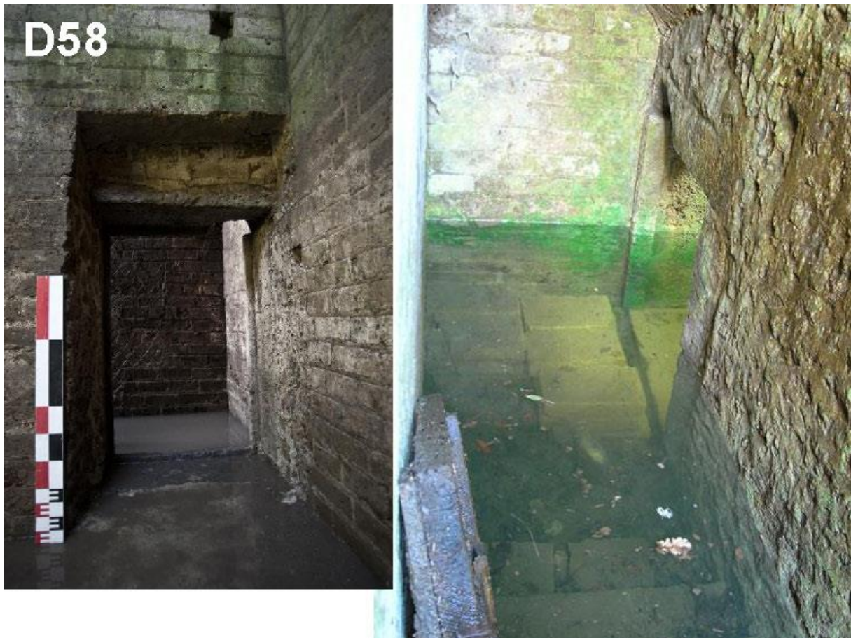
Fig. 6 : porte du monument D58. Intérieur à gauche, extérieur au pied de l'escalier d'accès à droite.
