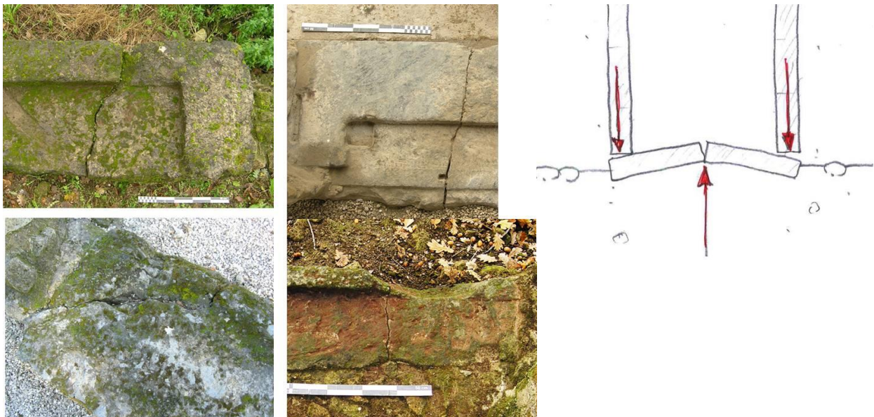
Fig. 5 : seuils brisés à la suite de tassements différentiels
