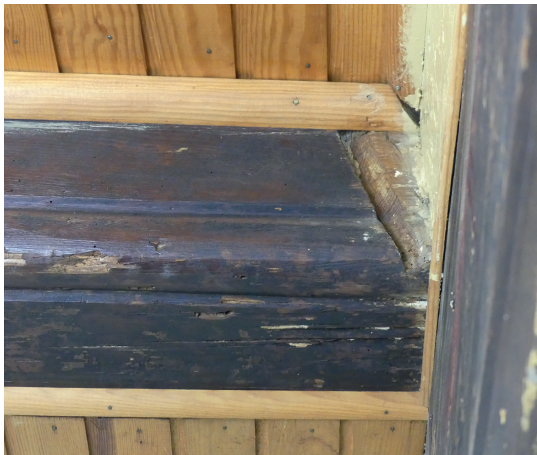
Fig.7 Détail de l'encoche de maintien d'un closoir (plaquette de bois obturant l'espace au-dessus de la poutre, entre les solives). Inrap cliché L. Wozny
