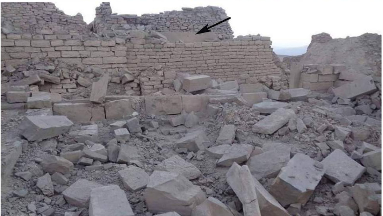
FIG. 21: Barāqish, temple de Nakrah après sa restauration en 2006 (haut) et après bombardement aérien en 2015 (bas). La flèche noire fournit un repère commun aux deux photographies (haut : J. Schiettecatte ; bas : GOAM).
