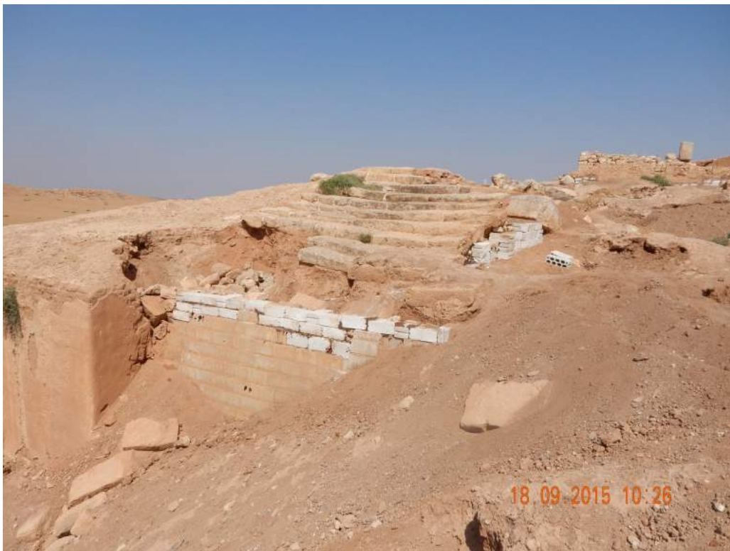
FIG. 15: Ebla : consolidation de l'escalier du palais G, avant et après notre intervention (© Idlib Antiquity Center).
