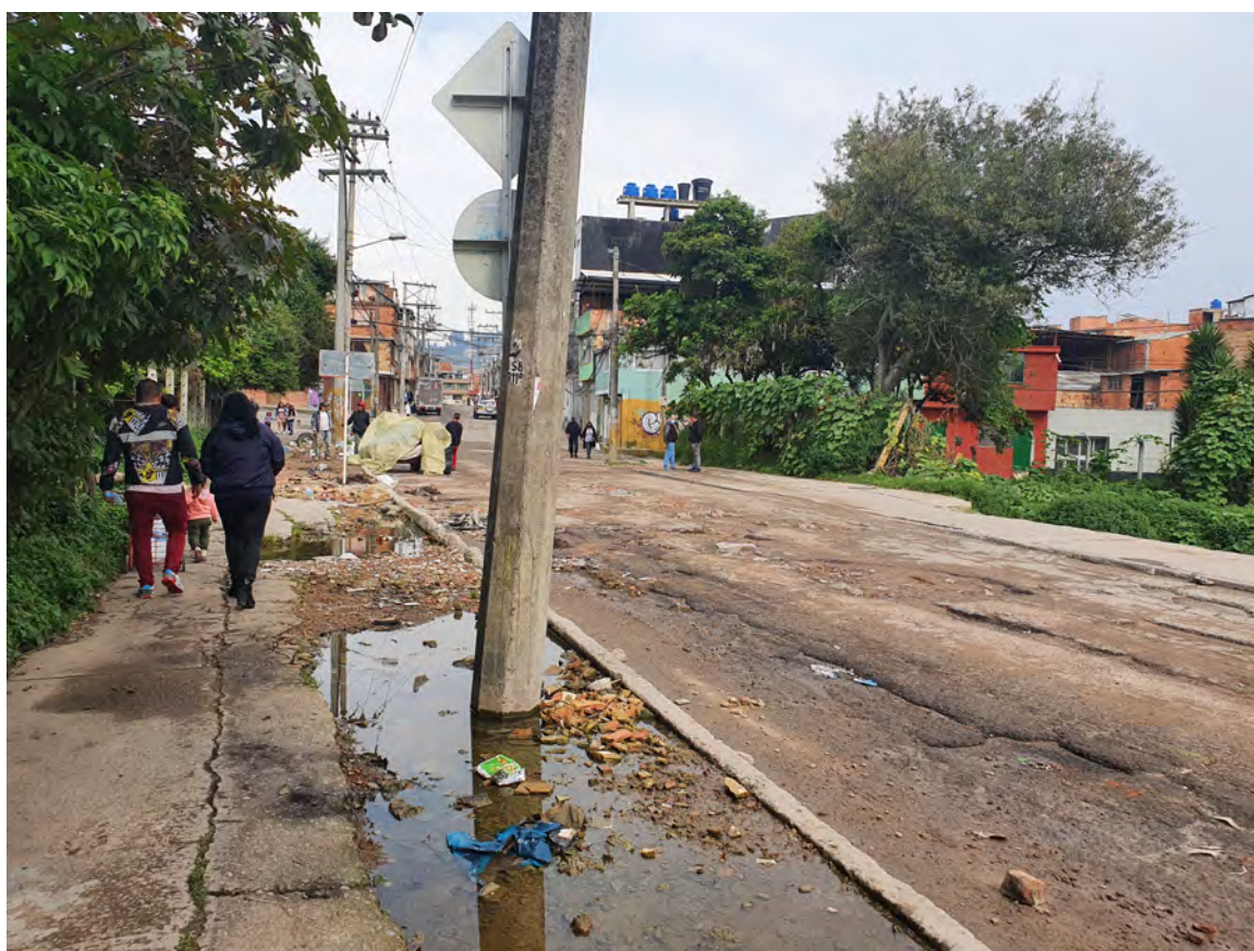
24. Chaussée et trottoir déformés par les intempéries et le manque d'entretien, dans le quartier de San Cayetano (Rincón de Suba) (Ducasse, 2022).
