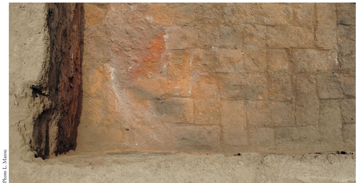
FIG. 9. P18, 2017. Phase 2, bâtiment 5, pièce 8. Traces d'incendie.
