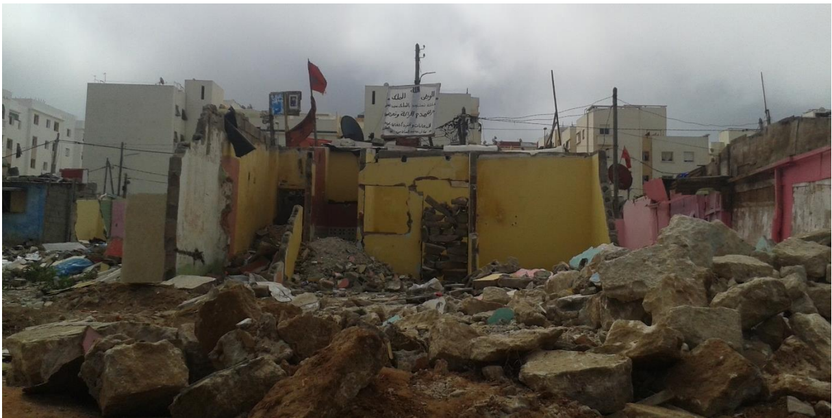
Fig.4 et 5 - Occupation des baraques pour résister à la démolition et aux modalités du relogement Photos A. Jeanjean/E.Campmas, mai 2016.
