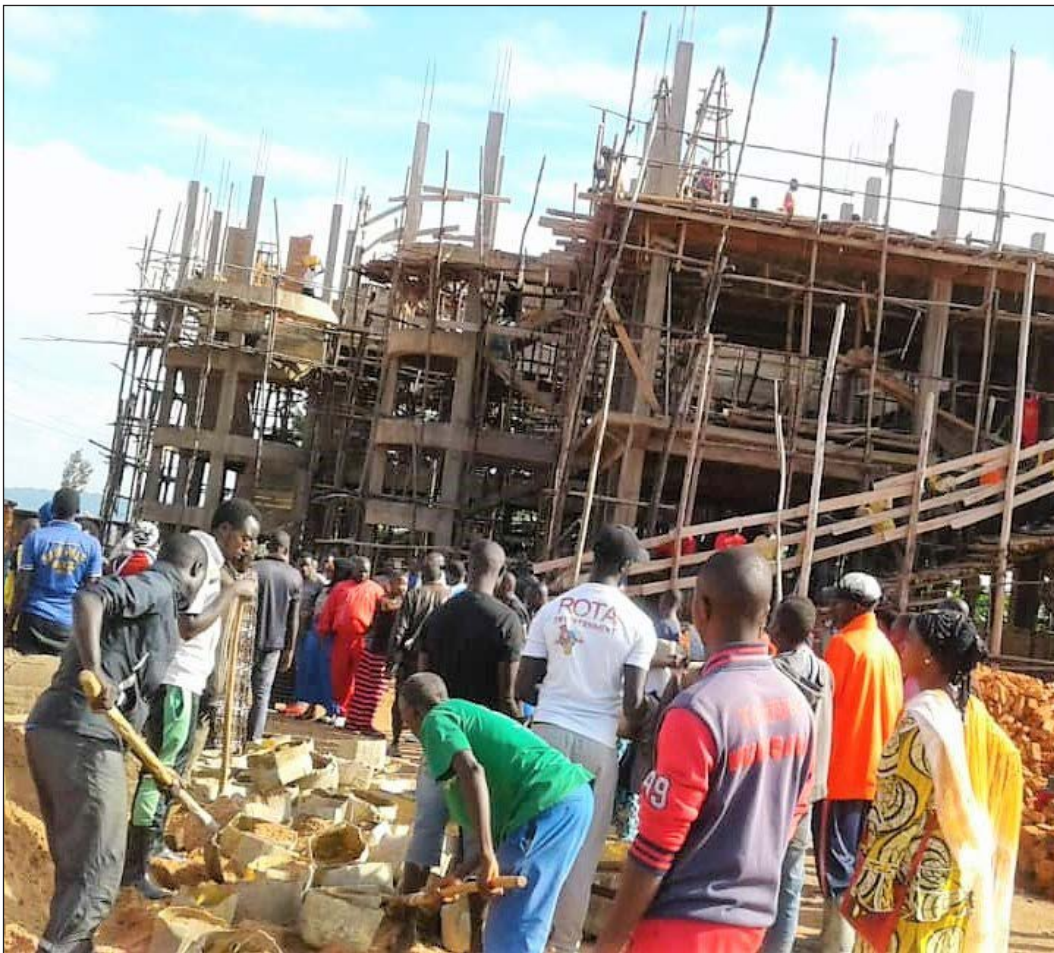
17. Binôme « Travaux communautaires » : construction de l'École technique secondaire du quartier Kinyami II, Ngozi, 25 mai 2019
