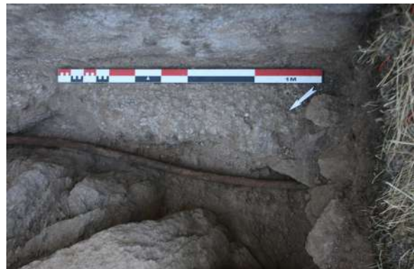
Fig. 206 : Réseau électrique sans ses chapeaux en terre cuite et plot en béton (photographie : L. Aymard et J. Brangé).
