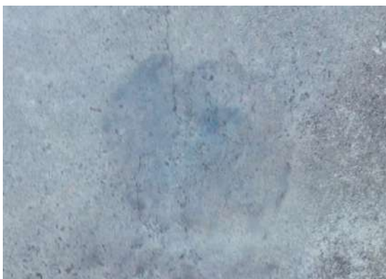
Fig. 378 : Tâche d'huile ou d'hydrocarbure sur la dalle de la halle 122 depuis le dessus (photographie : M. Landolt)
