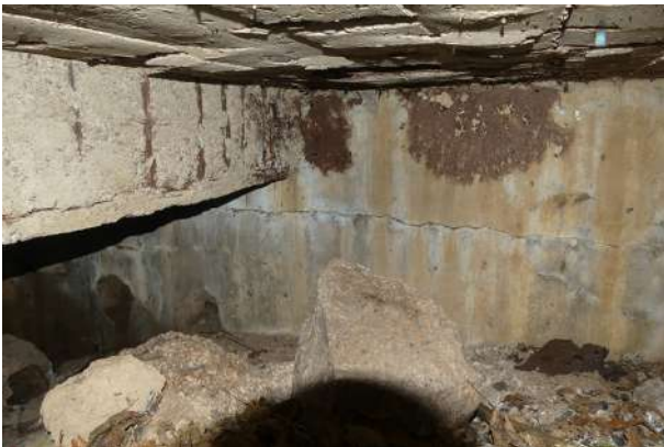
Fig. 509 : Intérieur de la pièce souterraine du compresseur (photographie : J. Brangé).
