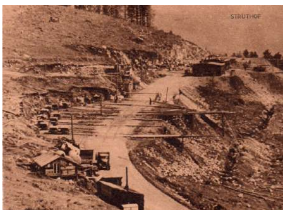
Fig. 89 : Travail en cours au sein de la carrière au printemps 1942 ( Frühjahr 1942 ) (NATZ19_PH_ARCH_001, CERD).
