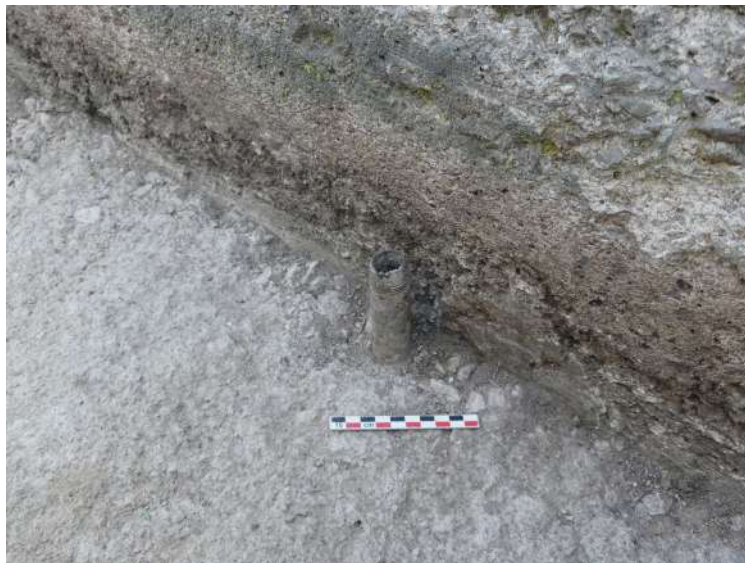
Fig. 392 : Détail de l'arrivée d'eau (US 3416) au niveau du lavabo ou du socle de machine ELA 122.02 depuis le nord-est (photographie : M. Landolt).
