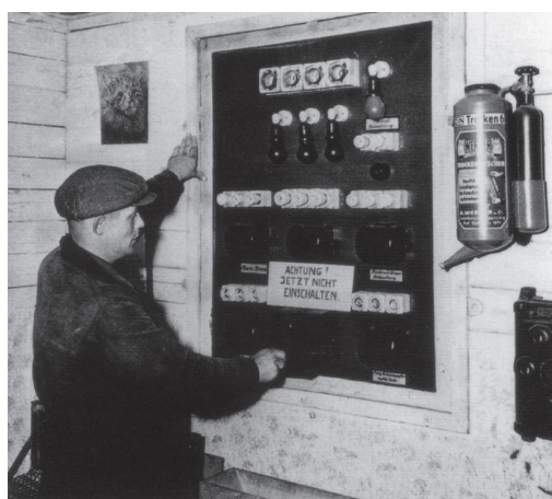
Fig. 636 : Tableau électrique du camp haut à la « Libération » (CERD).
