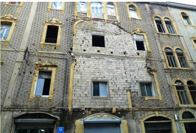
Figure 13 : Rue Gouraud : immeuble bombardé
