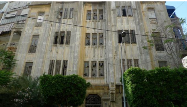
Figure 27 : Sanayeh : immeuble années 1920 dégradé
