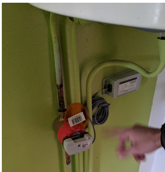
Image 23: Système de pilotage à distance et de collecte de données sous le ballon d'eau chaude électrique.
