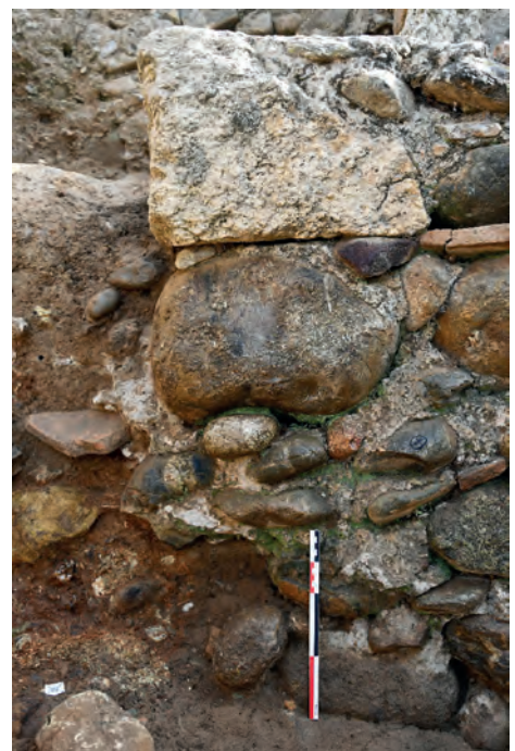
Fig. 57 : Vue de détail, depuis le sud, de la base de l'angle ouest du mur MR3145. Le ou les galets manquants ont fragilisé la construction. (photo : J. Bertaut)
