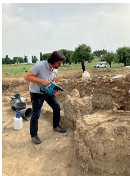
Zone 4 : démontage d'un plot de béton (support de la couverture en amiante réalisée en 1979) situé dans l'emprise de la fouille 2023
