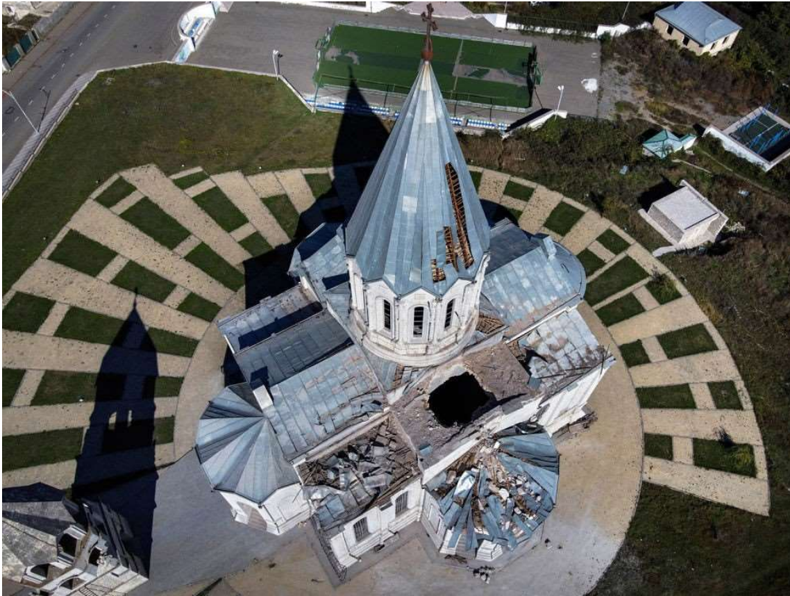
FIG. 66. CHOUCHI, CATHEDRALE SAINT-SAUVEUR (1868-1887). DOMMAGES CAUSES INTENTIONNELLEMENT ET SANS JUSTIFICATION, AU DOME EN OMBRELLE, A LA VOUTE DU BRAS SUD ET AUX TOITS, LE 8 OCTOBRE 2020. PHOTO EN LIGNE WIKIPEDIA
