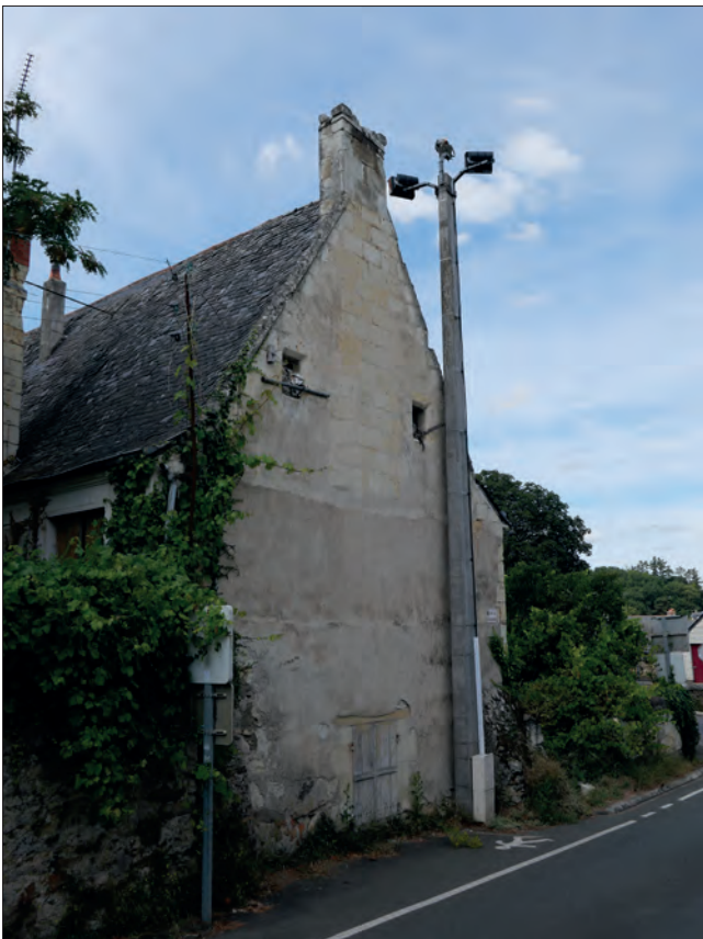
Fig. VII.3-7 - Vue du mur pignon nord depuis la rue du Pressoir-aux-Moines © Cliché E. Litoux.
