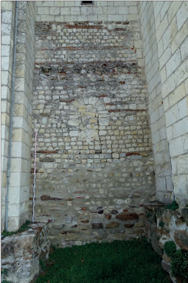
Fig. IV.28 - Parement extérieur du clocher de Saint-Vétérin présentant une alternance d'assises de moellons de tuffeau avec des briques © Cliché L. Déodat 2021.
