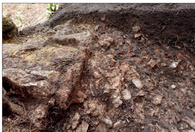
Fig. VI.3-34 – Détail du radier 1050 et de la paroi septentrionale du conduit enduite de mortier de tuileau © Cliché M. Bellanger, juin 2023.
