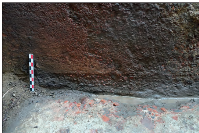
Fig. VI.2-56 - Absence de jonction entre l'enduit hydraulique de la paroi nord et le sol de béton © Cliché L. Déodat 2023.
