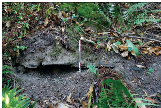
Fig. VI.2-70 – Tronçon de l'aqueduc à Mazerolles apparaissant dans le talus, et couvert par la végétation : on distingue la couverture en schiste ardoisier d'un côté, et celle en grès de l'autre © Cliché L. Déodat 2021.
