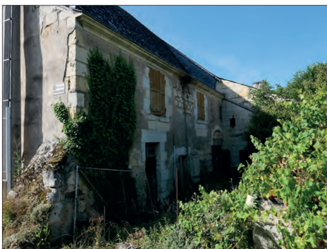
Fig. VII.3-3 - Vue de la façade ouest de la maison depuis la rue du Pressoir-aux-Moines © Cliché E. Litoux.
