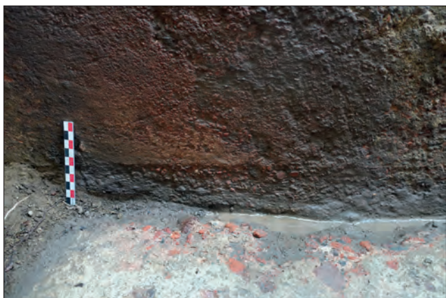
Fig. VI.2-56 - Absence de jonction entre l'enduit hydraulique de la paroi nord et le sol de béton © Cliché L. Déodat 2023.
