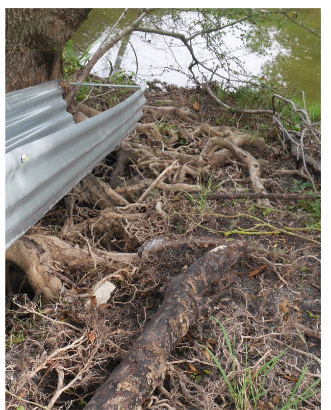
Tissu racinaire de frênes à nu sur la levée du Bois-Dieu suite à des écoulements en surface (St-Pierre-le-Vieux, septembre 2021).
