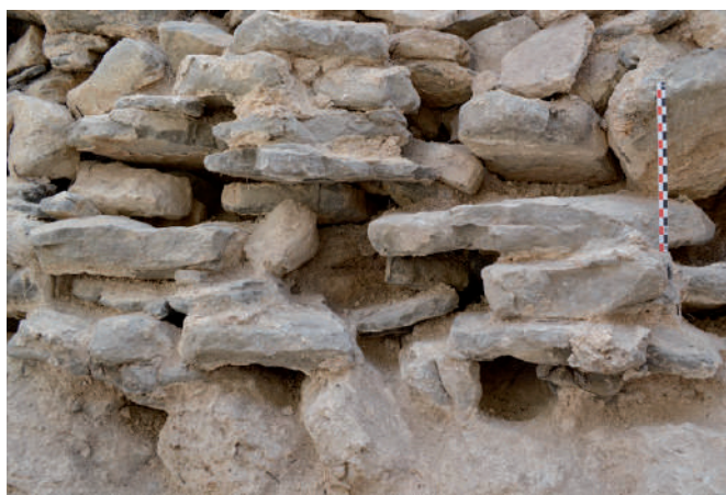
Fig. 12 Détail des espaces laissés entre les pierres à chaux dans la charge (cl. C. Vaschalde).
