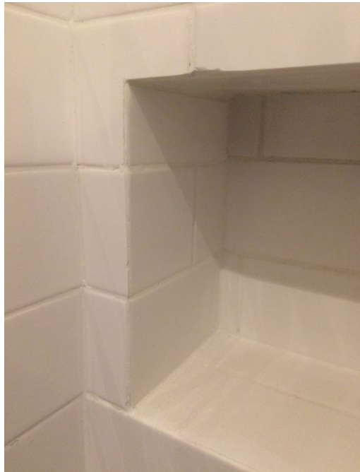
Nelson, habitant. Travail mal réalisé.
