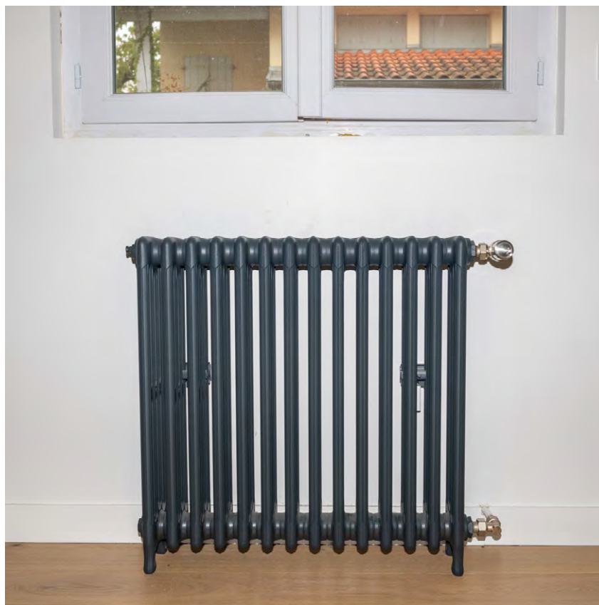
Radiateur rénové (T2)
