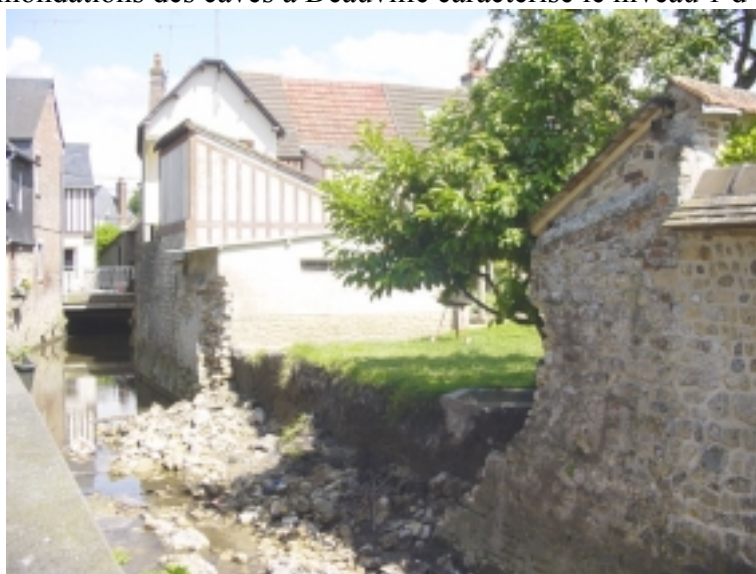
Figure 5.5 Destructions des murs sur la commune de Touques lors de l'inondation du juin 2003. (photo : F. Bahoken)
