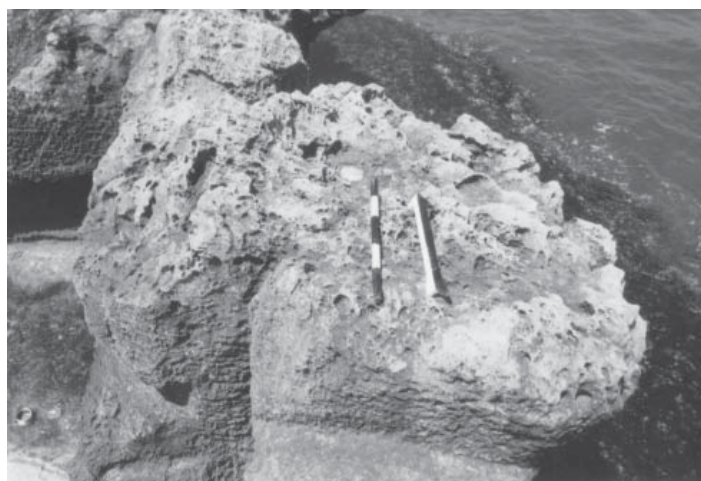
19.75. Borne d'amarrage n° 31 entamée par l'extraction de la roche (2003).
