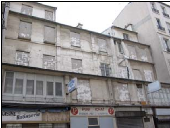
Image 56. Un immeuble muré et des commerces vacants dans le faubourg du Temple (rue Bichat, mai 2005)
