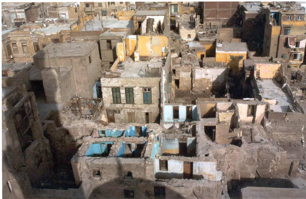
Photo 1-18 : Vue du quartier de Gamaliyya. Les toits des maisons sont détruits mais les étages restent en partie habités. ES, 1996.
