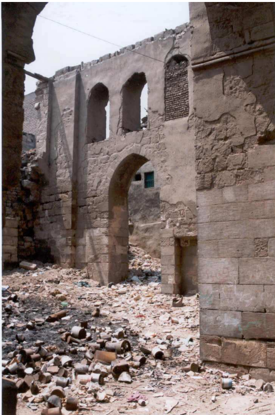
Photo 1-19 : Tas d'ordures dans un édifice historique (hôpital du XVI e siècle aux pieds de la Citadelle). Le monument est en ruine et les ordures qui s'accumulent sont régulièrement brûlées par les populations. ES, 1999.
