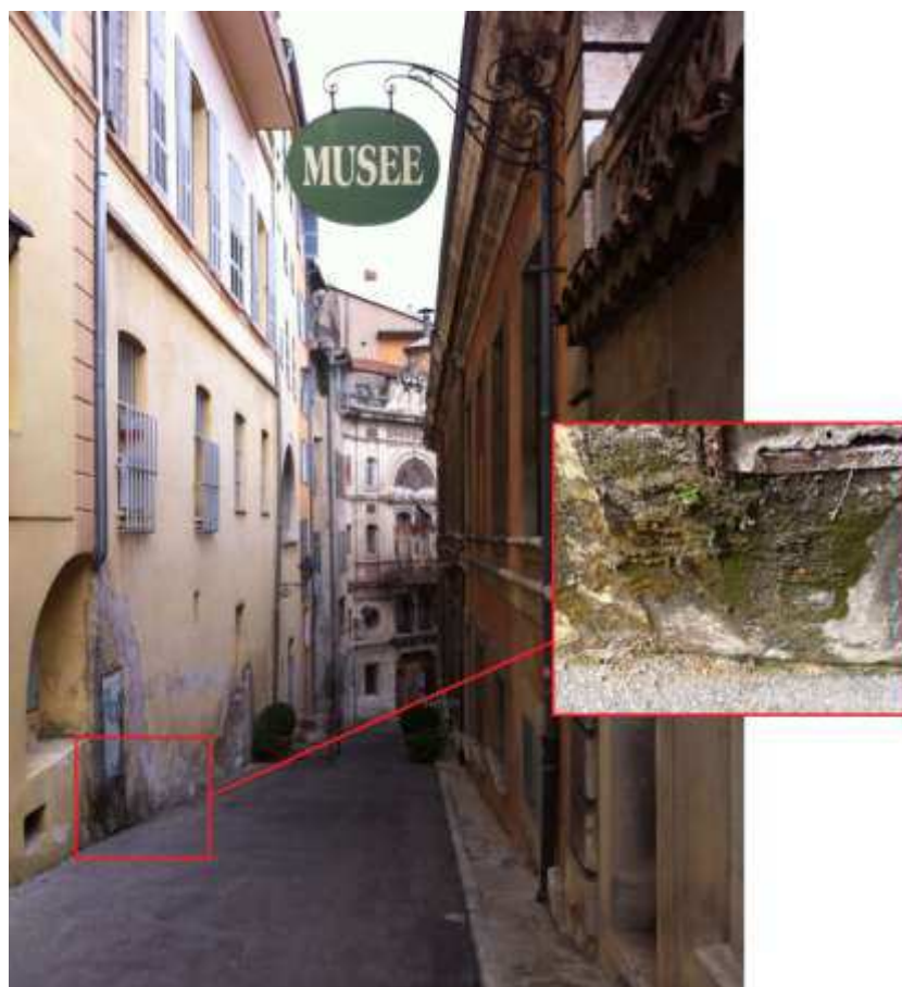
Fig. 83 - Face au MAHP, le mur est rongé par l'humidité issue d'un canal passant sous le bâtiment
