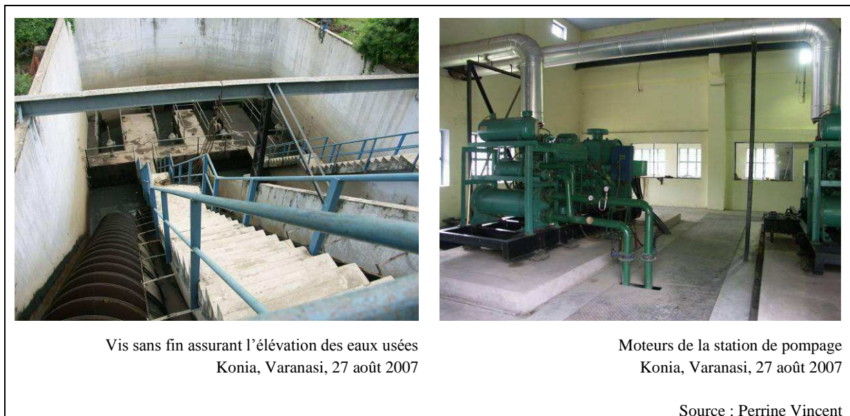
Photographie 19 – station de pompage principale
