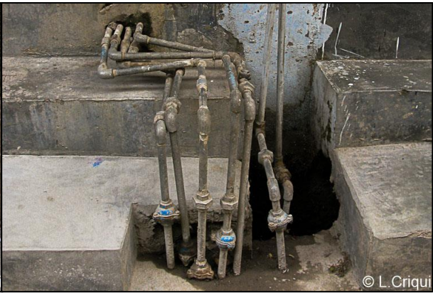
Photo 49/D. Connexions individuelles d'un immeuble (Delhi, Vinod Nagar, 11/03/2013)
