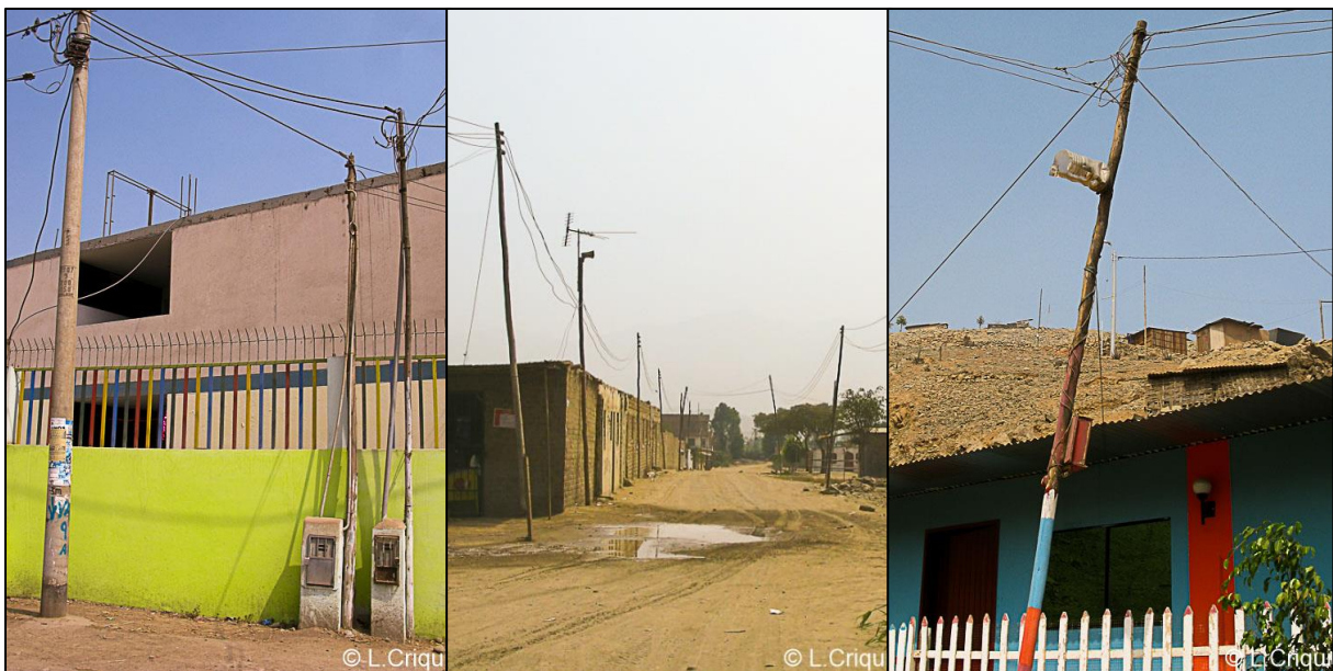
Photo 36/L. Dernier poteau du réseau et macro-compteur
