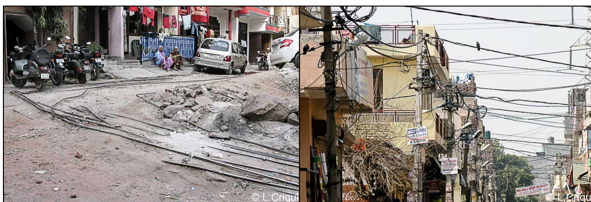
Photo 12/D. Réseau d'eau clandestin (Delhi, Sheikh Sarai, 10/03/2013)
