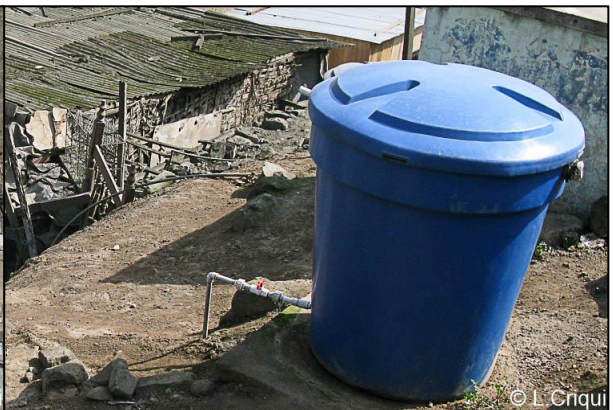
Photo 44/L. Plomberie domiciliaire extérieure (Lima, Comas, Collique, 29/08/2012)
