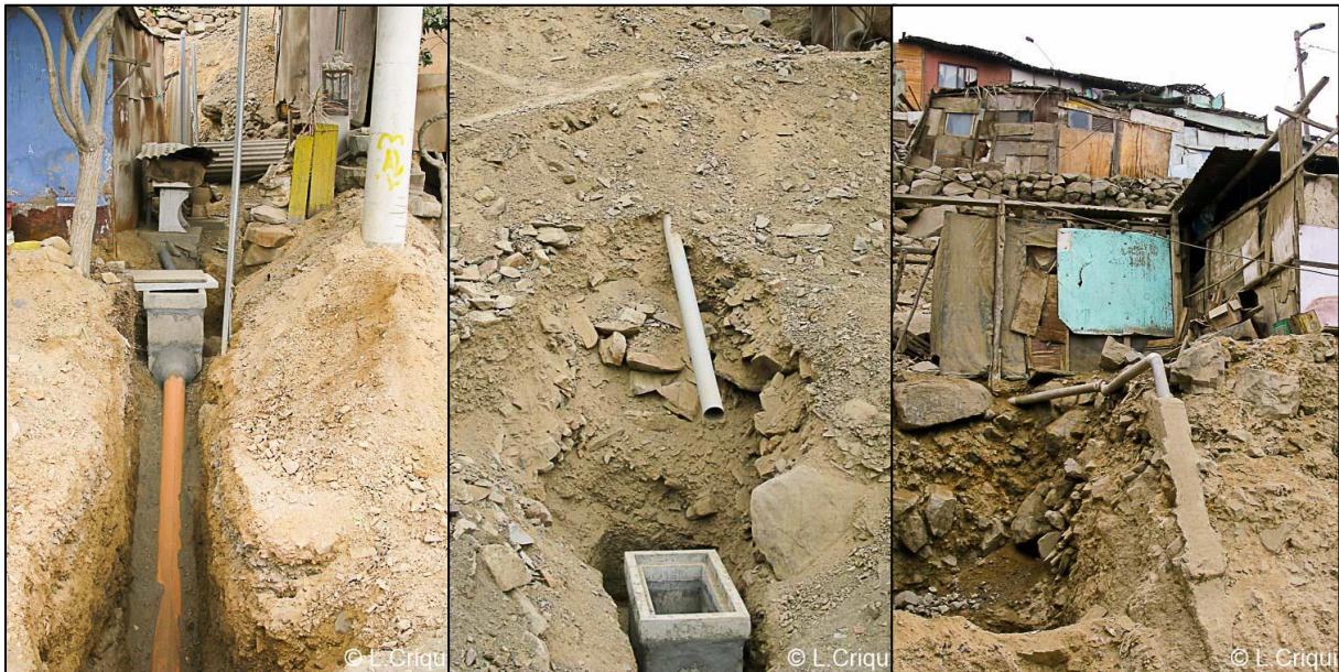
Photo 45/L. Égout condominial
