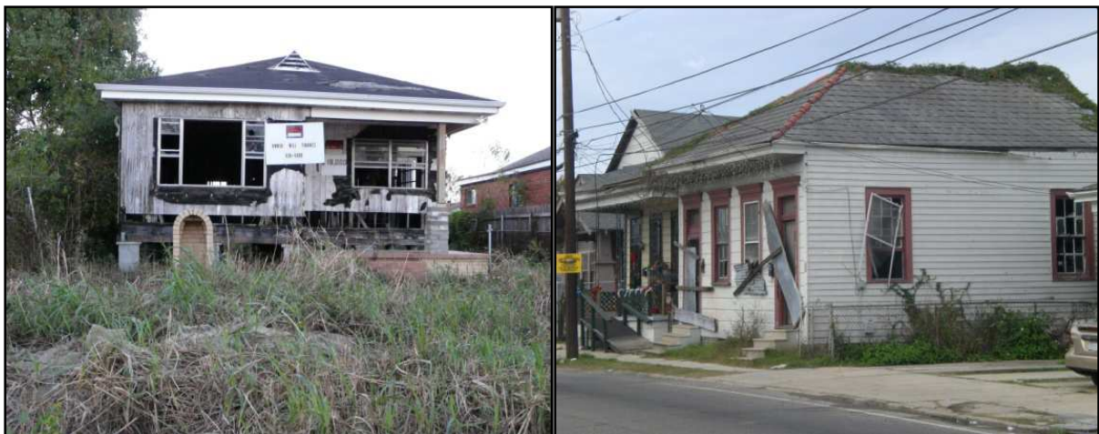
Figure 45 : Blight urbain caractérisant les quartiers défavorisés de St Claude et du Lower 9th Ward , subissant les effets de la crise urbaine au cours des décennies pre Katrina (clichés de l'auteur, 2011).
