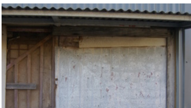
Figure 169 (PHOTO) : Obturation complète de terrasse par des matériaux de fortune (Opération réhabilitée, Ravine Blanche)
