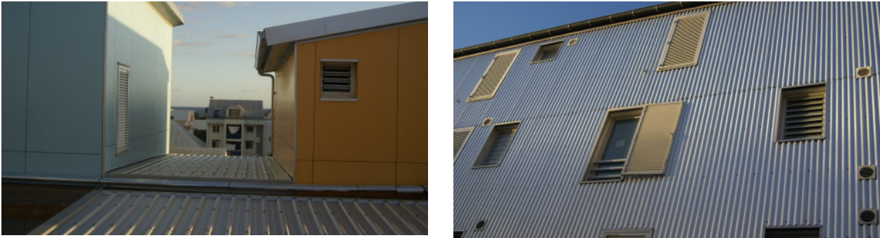
Figure 147: Le choix de matériaux réfléchissants et/ou aux couleurs claires en vue de limiter la captation de chaleur sur les éléments exposés. Surfaces horizontales (Opérations Aldabra et Ilet du centre)
