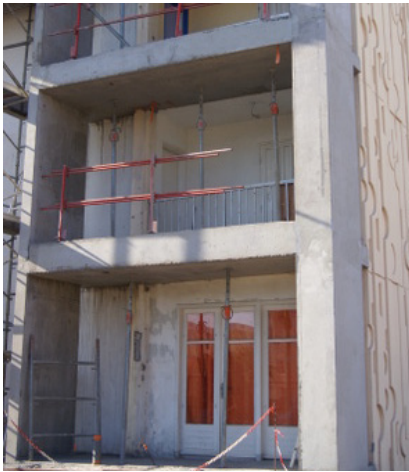
Figure 241 (PHOTO): Création d'ouvertures supplémentaires sur les bâtiments; rallongement de façades (Opérations Bons Enfants)
