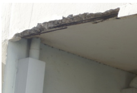
Figure 208 (PHOTO) : Dégradation des structures avec le temps
