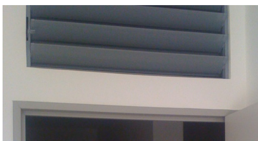
Figure 131 (PHOTO) : Persiennes au-dessus des portes intérieures du logement pour favoriser une ventilation traversante (Opération Le Belvédère, Beau séjour, Sainte-Marie)
