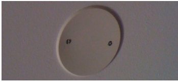
Figure 133 (PHOTO) : Des logements pré-équipés dès leur livraison de prises en plafond pour brasseurs d’air (Opération Le Belvédère, Sainte-Marie)
