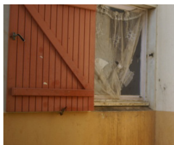
Figure 209 (PHOTO) : Des logements sociaux devenus insalubres au bout de 30-40 de location
