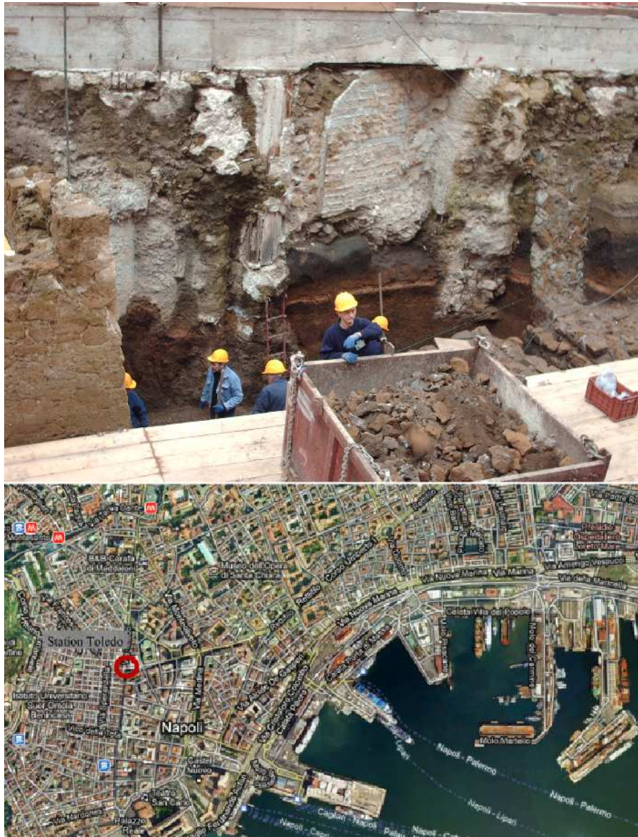
Photographie 2.8 Les travaux de la Station Toledo (Ligne 1) pris dans le patrimoine archéologique
