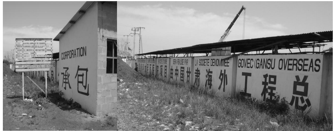
Façade du chantier de l'hôpital de Gagnoa construit par la société GOVEC. Gagnoa. 21 février 2010.
