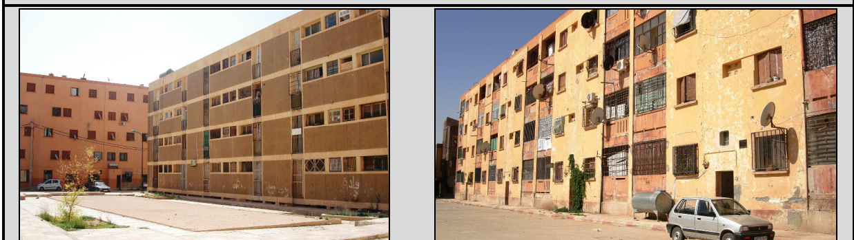
Photos -55- et - 56- Ces bâtiments réalisés au début des années 1960, ont introduit la typologie « barres en béton armé » à Djelfa et sont toujours occupés, malgré l'état dégradé et l'exigüité des logements
