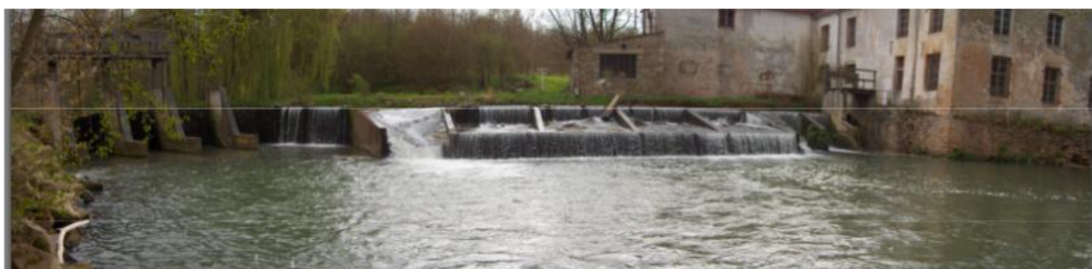
Figure 61 : Déversoir du moulin du Pont sur le Grand Morin. (Source : Philippe Busch).
