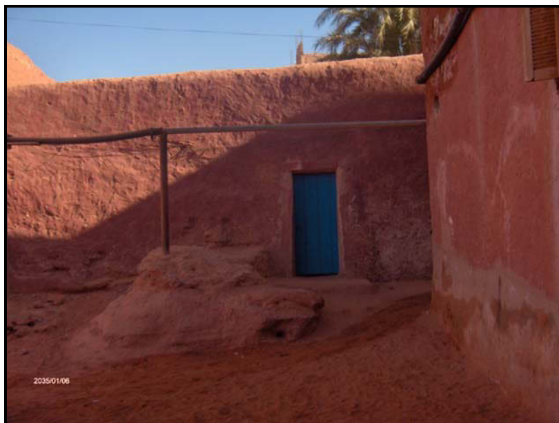
Photo n° 60. Aménagement ou bricolage d'un réseau d'assainissement apparent dans le ksar de Timimoun
