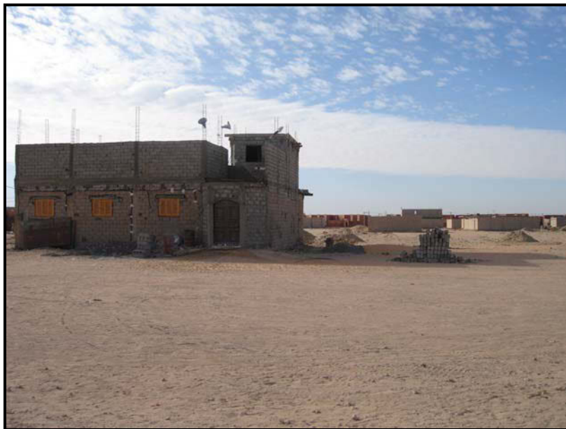
Photo n°49. Coopérative immobilière à Adrar (Cheik-Mohamed-Ben-Lekbir): retard flagrant dans la construction (excepté une salle de prière destinée pour la cité des logements sociaux et LSP)
