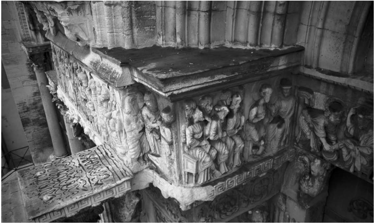
Abb. 76 Nördliches Auflager der Hauptportalarchivolten, Anschluss des Passionsfrieses an den Türsturz und Versprung des Gesimses
