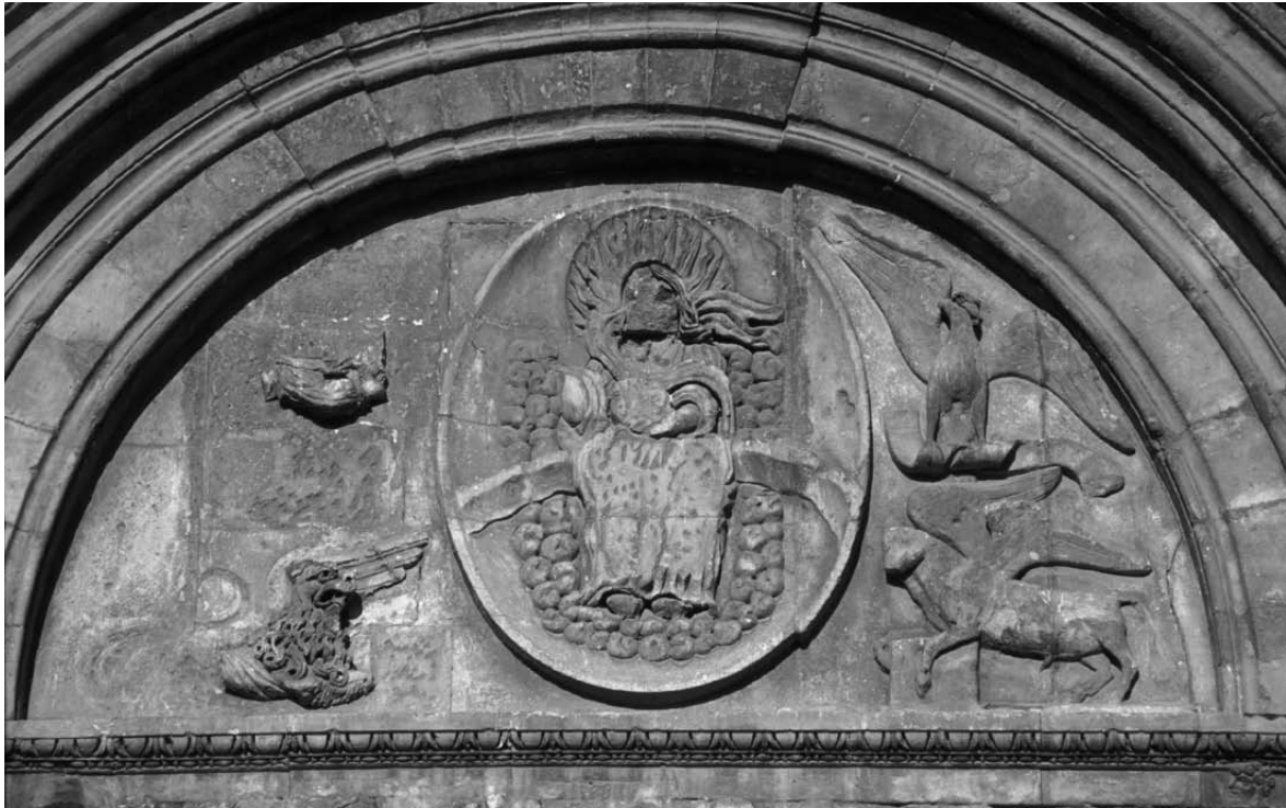
Abb. 78 Tympanon des Hauptportals mit Reparaturen des 17.Jh.
