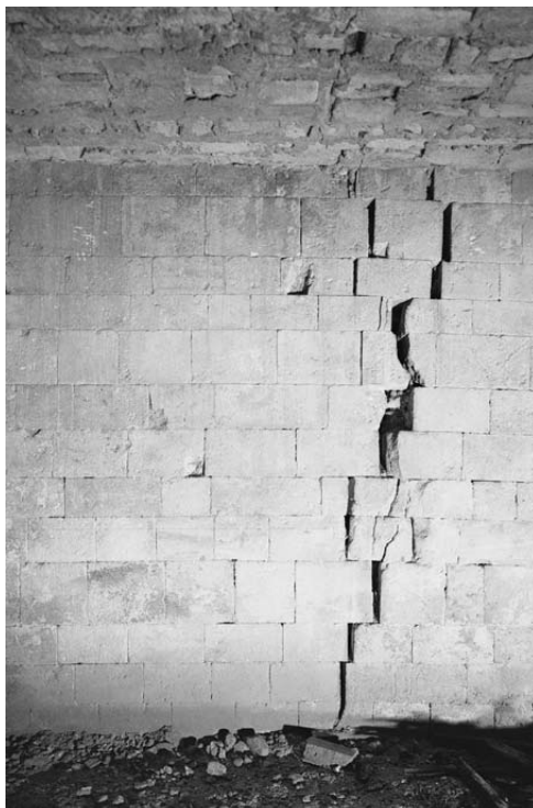
Abb. 70 Raum unter der Treppe - Bauschaden im Mittelrisalit (A. Schlamann)
