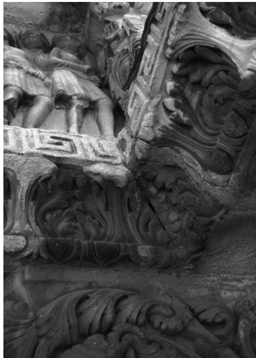
Abb. 107 Kämpferplatte der südlichen Doppelsäulenkonstruktion Ungewöhnlicher Anschluss mit Gehrungsschnitt
