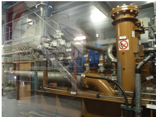
Photo 38 : Le générateur électrique de la MHKW
