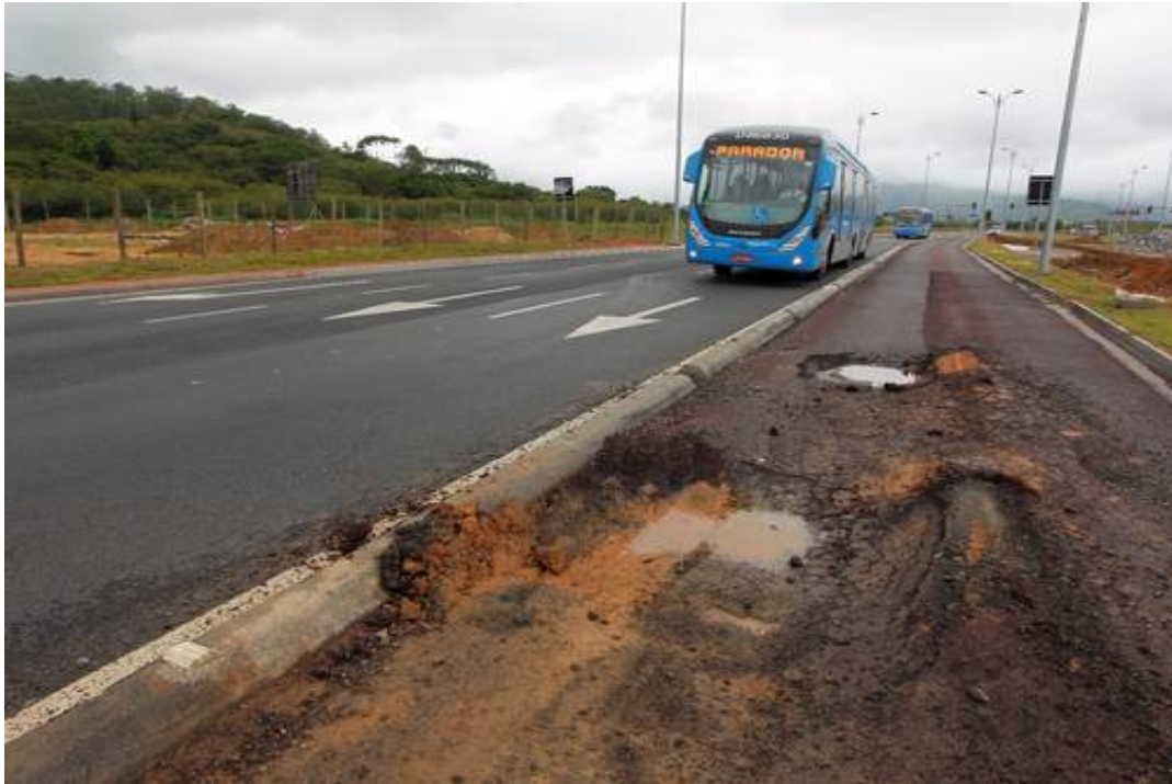
Figure 10 - Des problèmes d'infrastructures viaires sur la piste exclusive du BRT : des trous dans la chaussée six mois après l'inauguration, le bus sortir de sa piste exclusive
