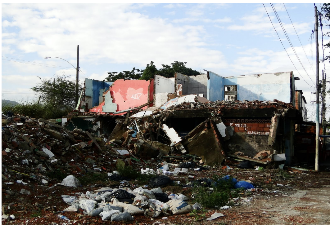
Figure 20 - Décombres des maisons détruites pour l'expropriation de Vila Harmonia (2011)
